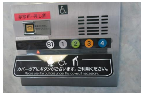
図1-2-4:各階停止ボタン
