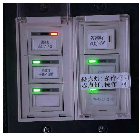
図 15 コンソールにある独立照明スイッチ等の配置
