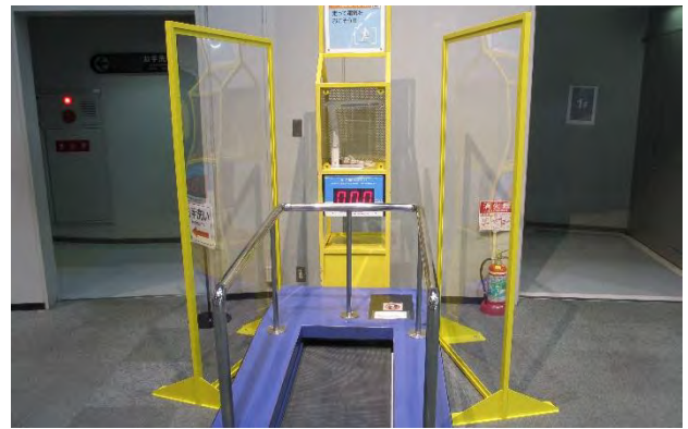
写真7. 「ジョギング発電」(改修後)
