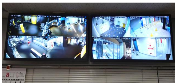
写真 2-15. 事務所内監視モニター
